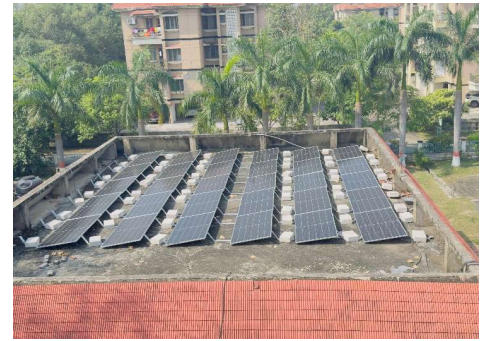
5) Vaishali club 30 KWp
